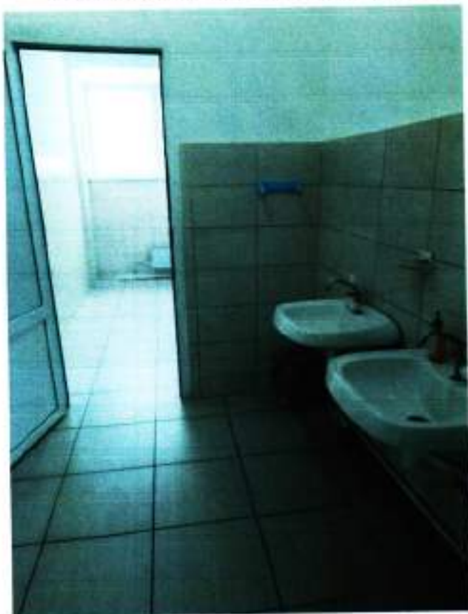
Фото № 15 Раковины в туалетной комнате
