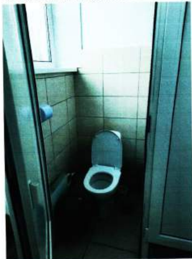
Фото № 16 Унитаз в туалетной комнате
